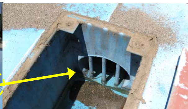
図 9 循環ろ過用の取水配管口
